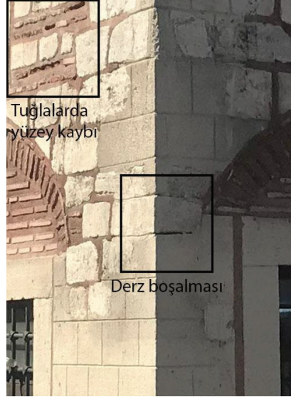
Görsel 20. Nur-u Osmaniye Camisi'ne bakan güney ve doğu cephelerinin kesişim noktasında görülen derz boşalması ve güney cephesindeki tuğlalarda yüzey kaybı.
