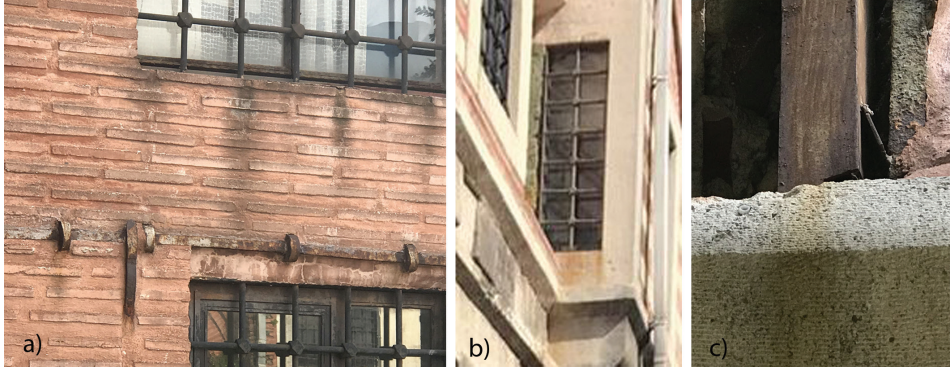
Görsel 26. a) Üst kattaki revakın doldurulmasıyla elde edilmiş cephede pas lekeleri. b) Güney cephede lokma parmaklıklar sebebiyle pas lekeleri. c) Avlu cephesinde paslanmış payandalar ve altındaki taşa lekelenme
