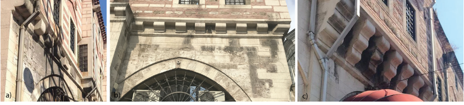
Görsel 25. a) Siyah tabaka oluşumunun tespit edildiği güney cephe (a), batı cephe (b, c).
