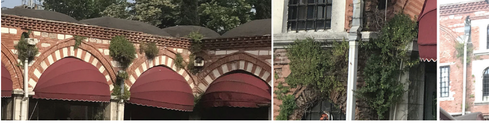
Görsel 29. Revak cephelerinde bitki oluşumu.
