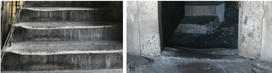
Görsel 22. a) Batı revaktaki dökme mozaik merdivende görülen aşınma. b) Üst kattaki dükkânın eşiklerinde görülen aşınma.
