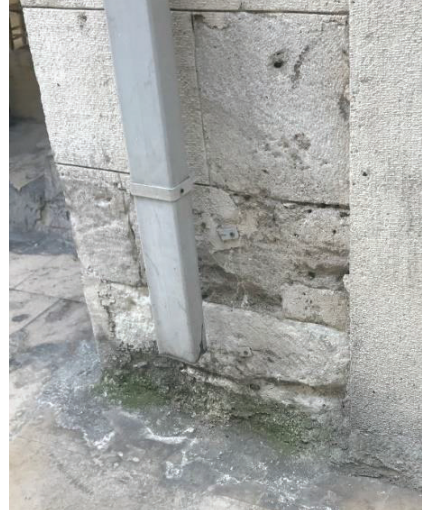
Görsel 21. Duvar üzerindeki taşlarda yüzey kaybı ve zeminde görülen yosun oluşumu ile tuz kristallenmesi.
