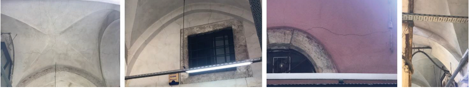
Görsel 19. Tonoz, kemer ve duvar üzerinde görülen çatlaklar.
