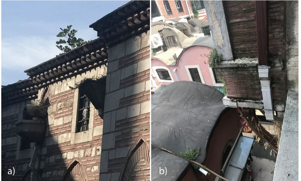
Görsel 30. Çatıda bitki (incir ağacı) oluşumu.
