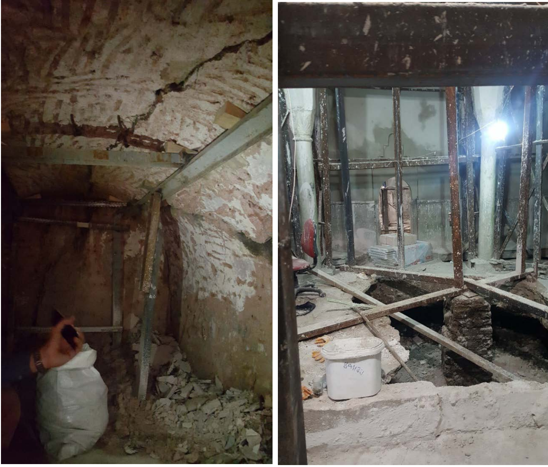
Şekil 17: Hamam külhan bölümü yapısal çatlak ve askıya alma işlemi (sol). Hamam sıcaklık bölümü döşeme müdahalesi (sağ). (Kaynak: Emre Kishalı arşivi, 2017).
