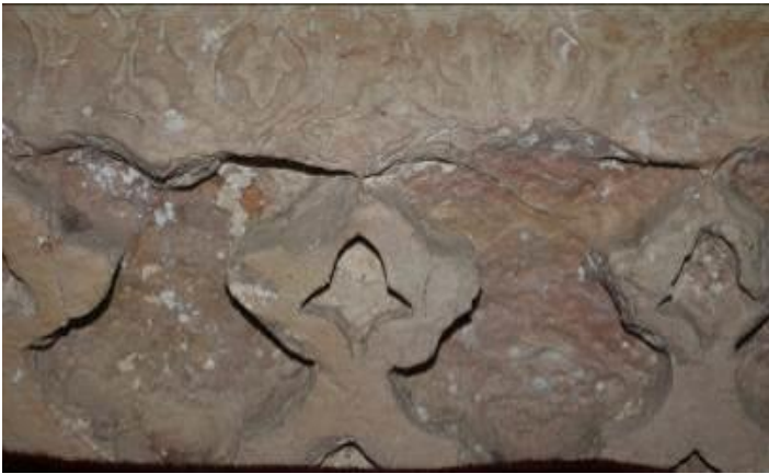
Fotoğraf 29. Kasımiye Medresesi Mescid Bölümü Mihrabı Kakma Tekniği Süslemelerden Düşen Taşların İzleri
