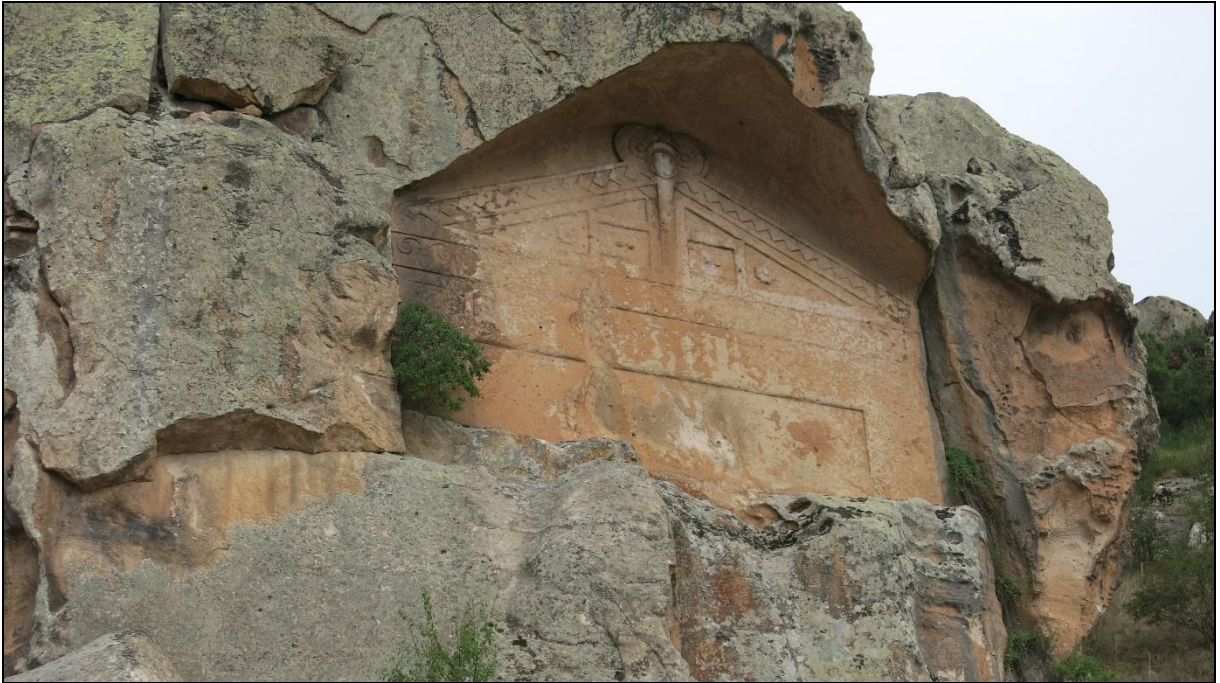
Res. 7: Bitmemiş Anıt Üzerinde Bulunan Çatlaklar ve Bitki Oluşumu
