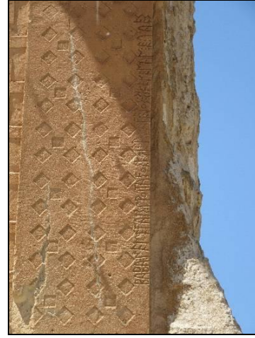
Res. 6: Anıtın Alt Kısmının Deformasyonu
