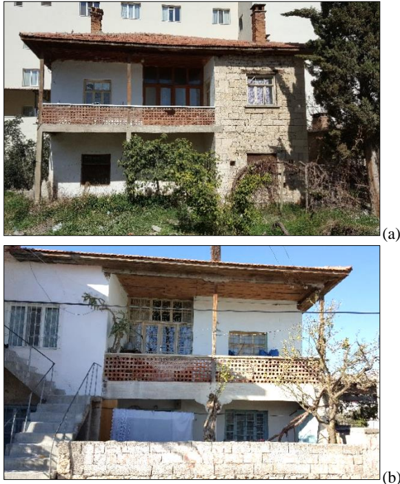
Şekil 3.16. (a) 1 numaralı yapının güneydoğu cephesi, (b) 4 numaralı yapının güney cephesi (a) Southeast facade of building number 1, (b) south facade of building numbered
