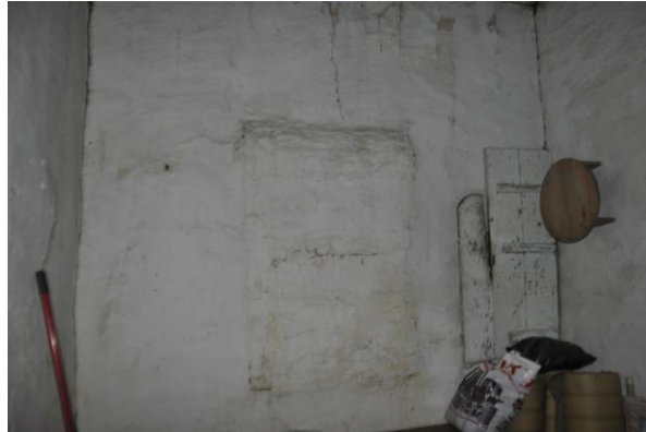
Şekil 20: Yapının kapatılmış pencerelerinden birinin izi (GTÜ Restorasyon Arşivi, 2016).
