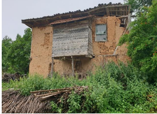
Şekil 23. 214 Ada 5 Parsel dışarıda tuvalet örneği 24 .
