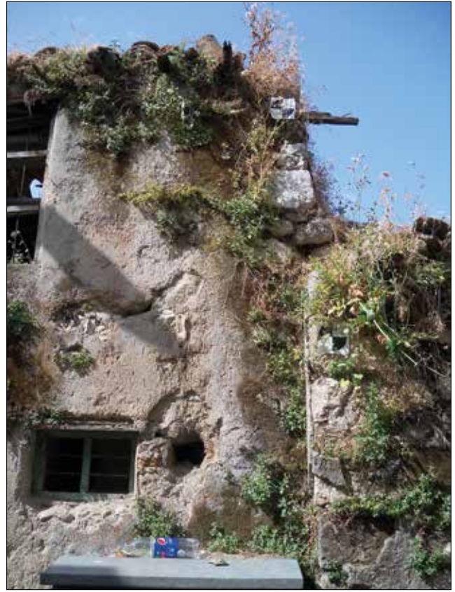
Fotoğraf 19. Yıkılan duvarın izi (Yazar, 2016). / Trace of the demolished wall.
