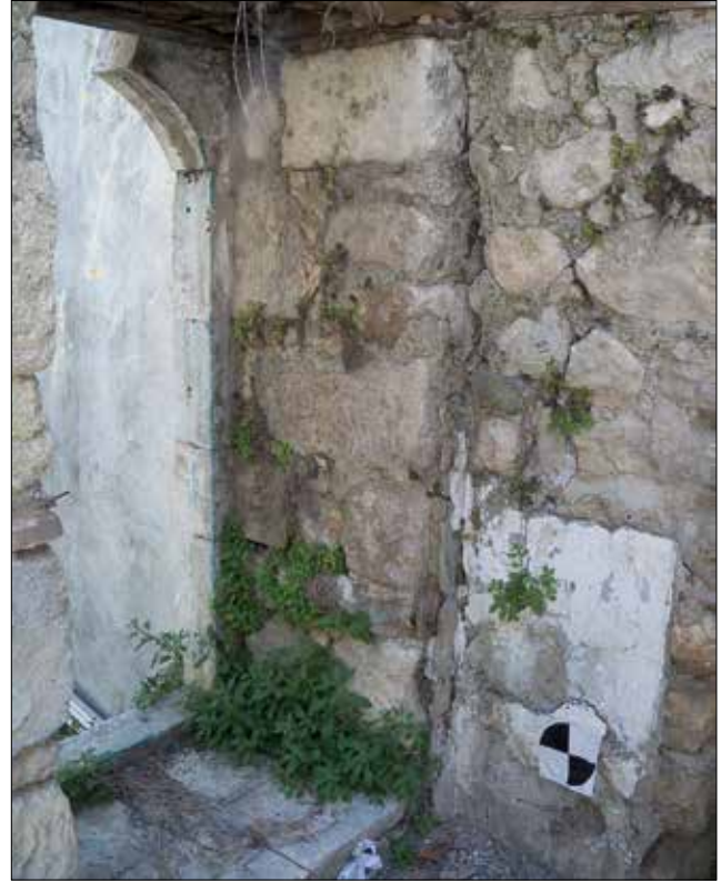
Fotoğraf 16. Duvar örgü sisteminin ayrıştığı köşe (Yazar, 2016). / Separate wall bonding.
