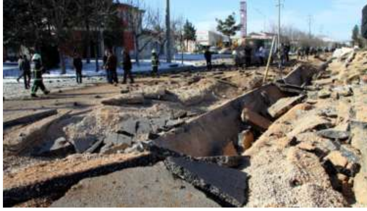
Şekil 1. Gaziantep-Doğalgaz Hattında Patlama [1]
