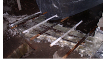
Fig. 8. Metal boruların eklendiği fibreglas zarf
