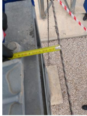
Resim 4. Testi yapılan kesici bakım öncesi aksel kaçıklık Photo 4. Tested breaker before maintenance misalignment
