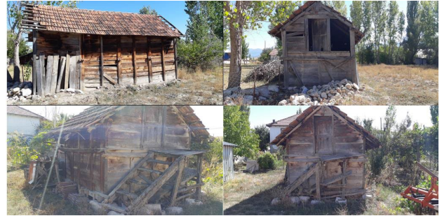
Şekil 21. Elmalı Hacı Musa Mahallesinde Bulunan Bakımsız Tahıl Ambarları
