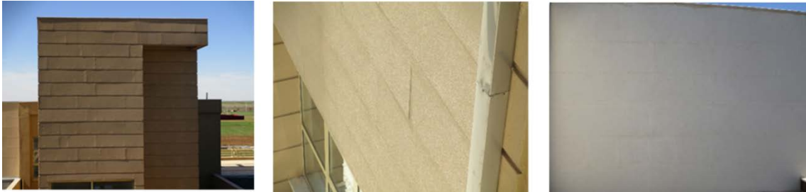
Şekil 2: Şanlıurfa Siverek 200 Yataklı Devlet Hastanesi cephelerinde sıva filesi imalatının donatı görevi görmemesi nedeniyle cephedeki bombe ve kalkmalar (Uygar Sarıaltın arşivinden; 2011)
