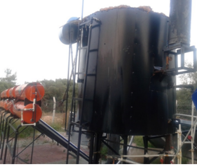
Şekil 11. Sağda, UZAYMER'deki Güneş havuzunu gösteren siyah silindirik yapı solda, güneş kolektörlerinin depoları olan turuncu yapılar görülmektedir.
