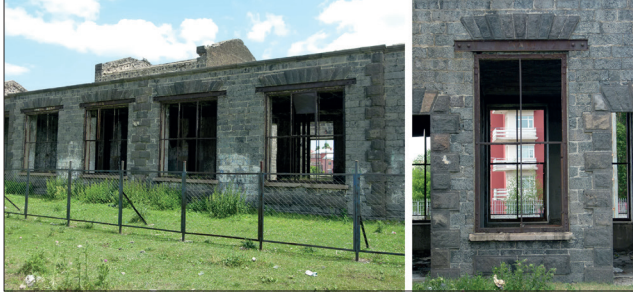
Fotoğraf 9: Geniş açıklıklı, çelik lentolu ve demir doğramalı pencereler / Wide span windows which have steel lintel and joinery windows
