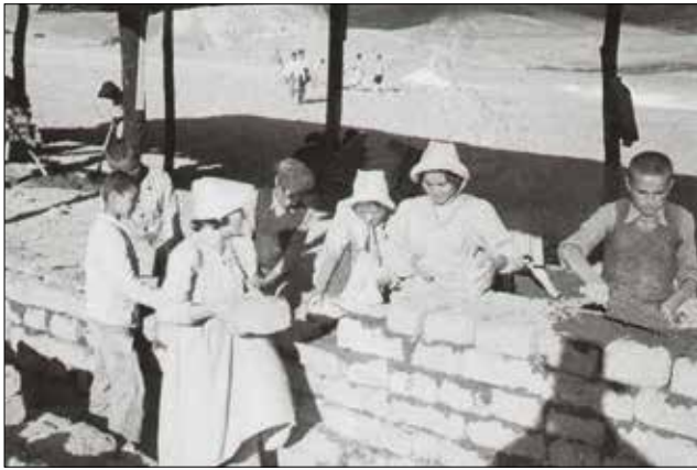
Figure 23: Construction of a brick wall above stone masonry (IHTBV). / Yığma taş duvar üzerine tuğla duvarın inşa edilmesi (IHTBV)
