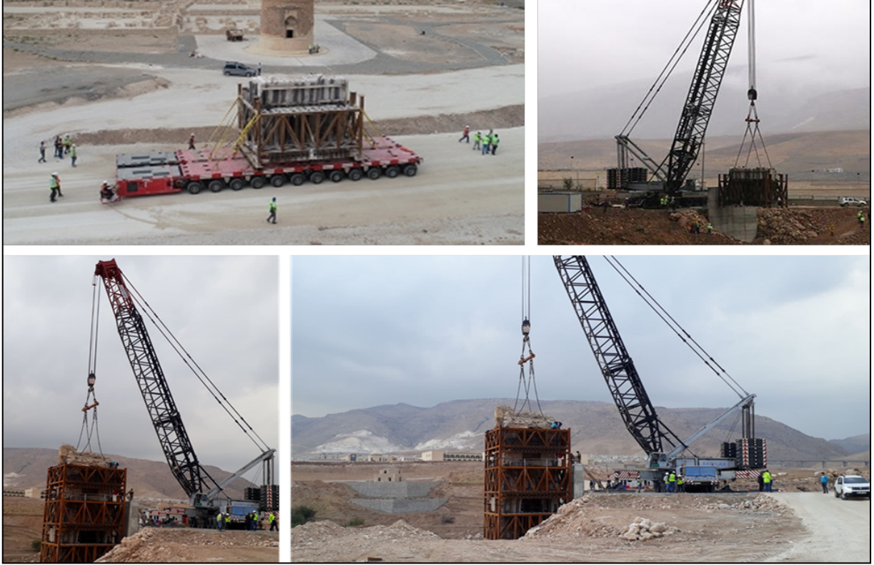
Fig. 10: Hasankeyf Orta Kale Kapısı'nı üç yapı bloğunun yeni Hasankeyf Yerleşkesi'nde yer alan Arkeopark Alanı'ndaki yeni nihai konumuna alınarak yeniden kurulum çalışması
