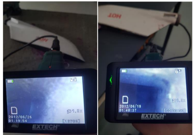
Şekil 3. Drain Mast komponentinin boroskop cihazı ile incelenmesi.
