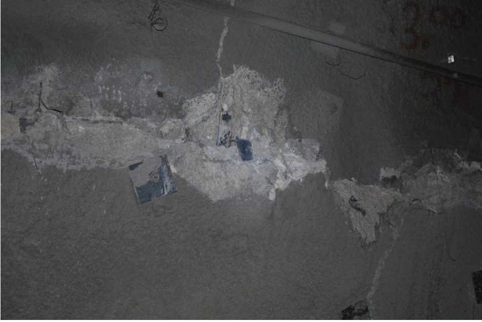
Őekil 7. Püskürtme betonda meydana gelen atlaklar.
