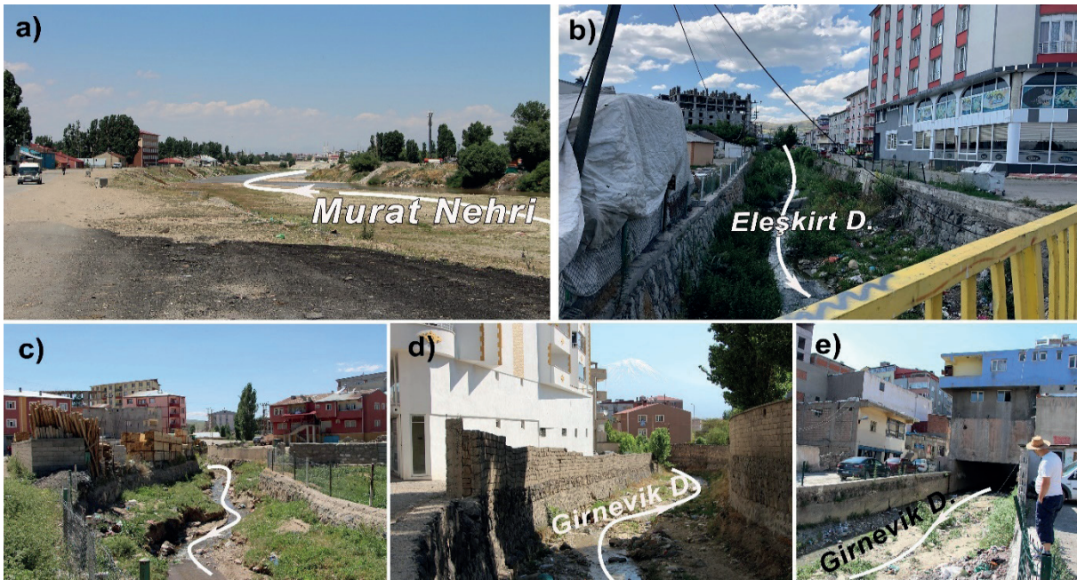
Foto 1: Ağrı (a), Eleşkirt (b), Diyadin (c) ve Doğubayazıt (d, e) yerleşmelerinde dere yatakları yerleşmeler tarafından işgal edilerek daraltıldığı için şiddetli yağışlar sonucunda afet boyutunda sel ve taşkın olayları yaşanmaktadır.
