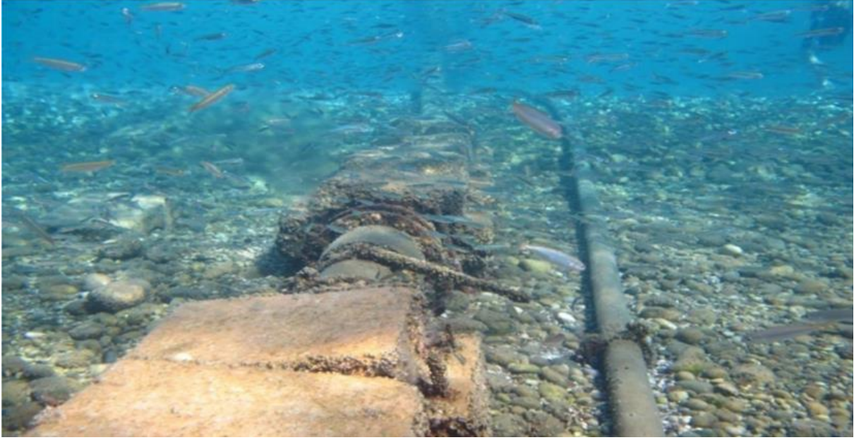
Şekil 1. Su alım ünitesinin kıyadaki başlangıç kısmı (kalın boru su alımı, ince boru elektrik iletimi)
