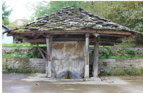
Fot. 42. Sinop - Ayancık Yenikonak (Otmanlı) Köyü Çeşmesi'nde taş çatı kaplama (say taşı / marla taşı).
