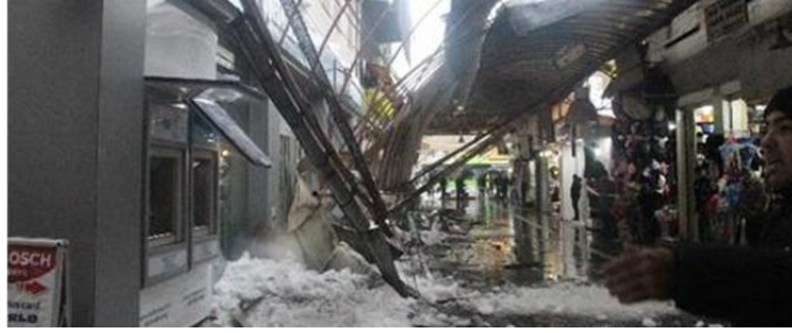
Figure 15. The collapse of the top cover due to snow load in 2015. (“Tarihi Uzunçarşı’nın Çatısı Çöktü”, 2015, January 10).
