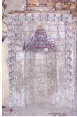
G. 4: Restorasyon Öncesi Mihrabın Durumu (Vakıflar Genel Müdürlüğü Arşivi, H. Yardımcı, 2005).
