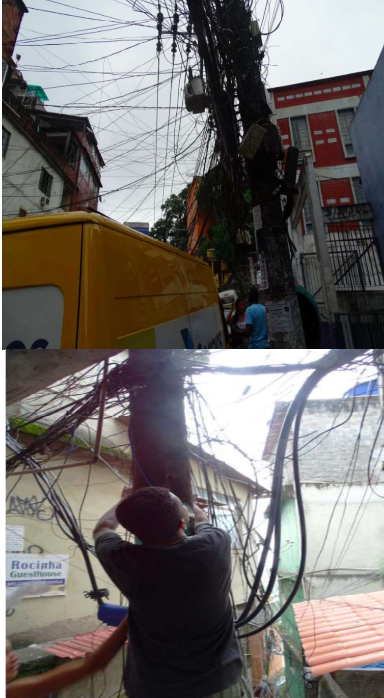
Fotoğraf 2. Rocinha favelasında kaçak elektrik hattı bağlanırken
