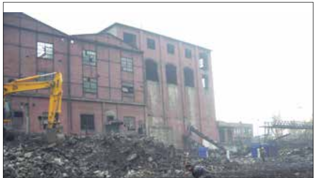
Fotoğraf 41: Zonguldak Liman'da yer alan Merkez Lavuar Tesisi (Yıkım Süreci) (TTK Arşivi, 13.11.2006) / Central Coal Washing Facility in Zonguldak Port (Before)
