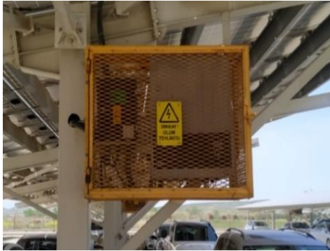
Şekil 6. PV altında konumlandırılmış invertör kabinleri
