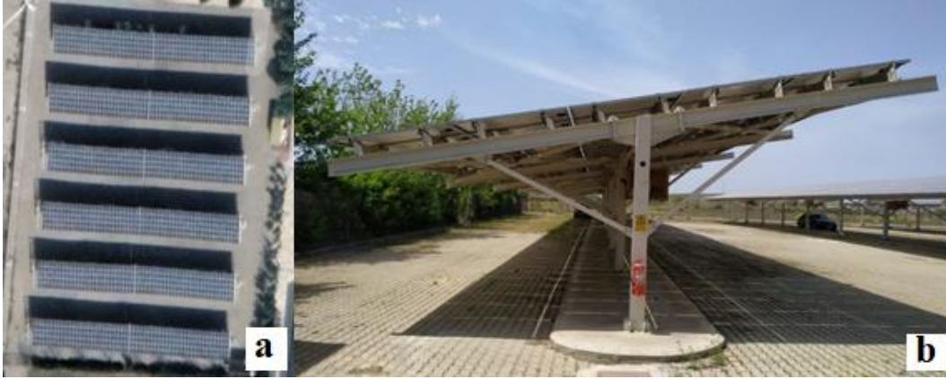
Şekil 5.a. PV panellerin dizilişi, b. Konstrüksiyon üzerinde yerleşim açısı
