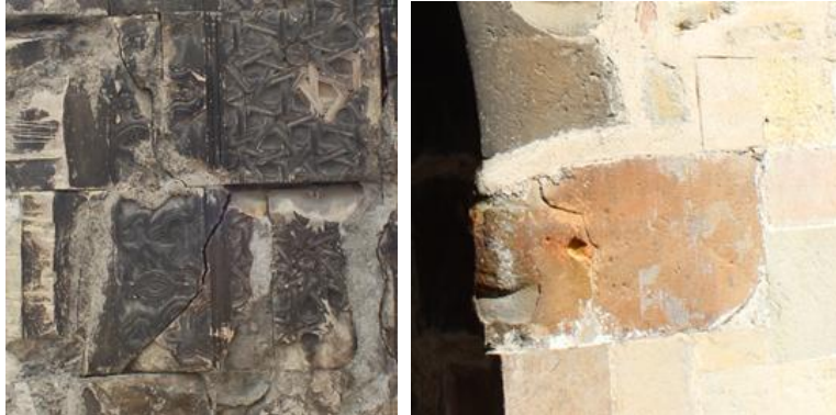
Fotoğraf 8: Taç Kapı, Sol Kapı Kuşağı, Kırık-Çatlak Fotoğraf 9: Taç Kapının Arkasındaki Sağ Destek Duvarı, Çatlak
