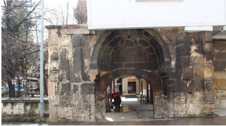
Fotoğraf 4: Taç Kapı, Sol Taraf Destek Duvarında Örgü Kaybı ve Taç Kapı Üst Kısımında Çoklu Birim Malzeme Kaybı
