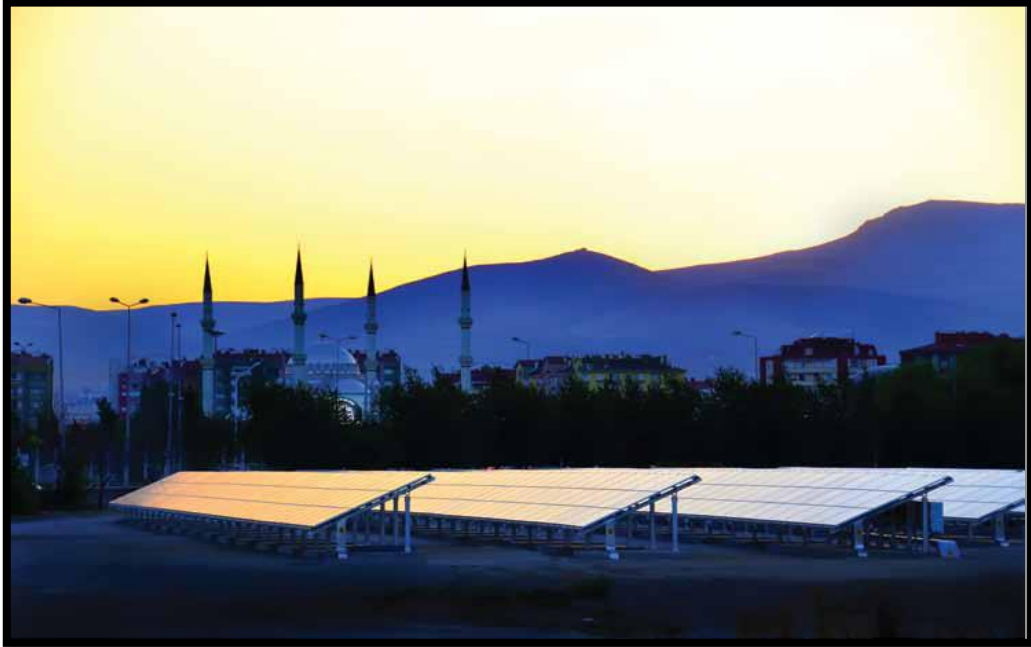
Şekil 10: Konya'daki IBC Solar Ltd. tarafından kurulan 200 kW'lık grig-conncted fotovoltaik sistem.
