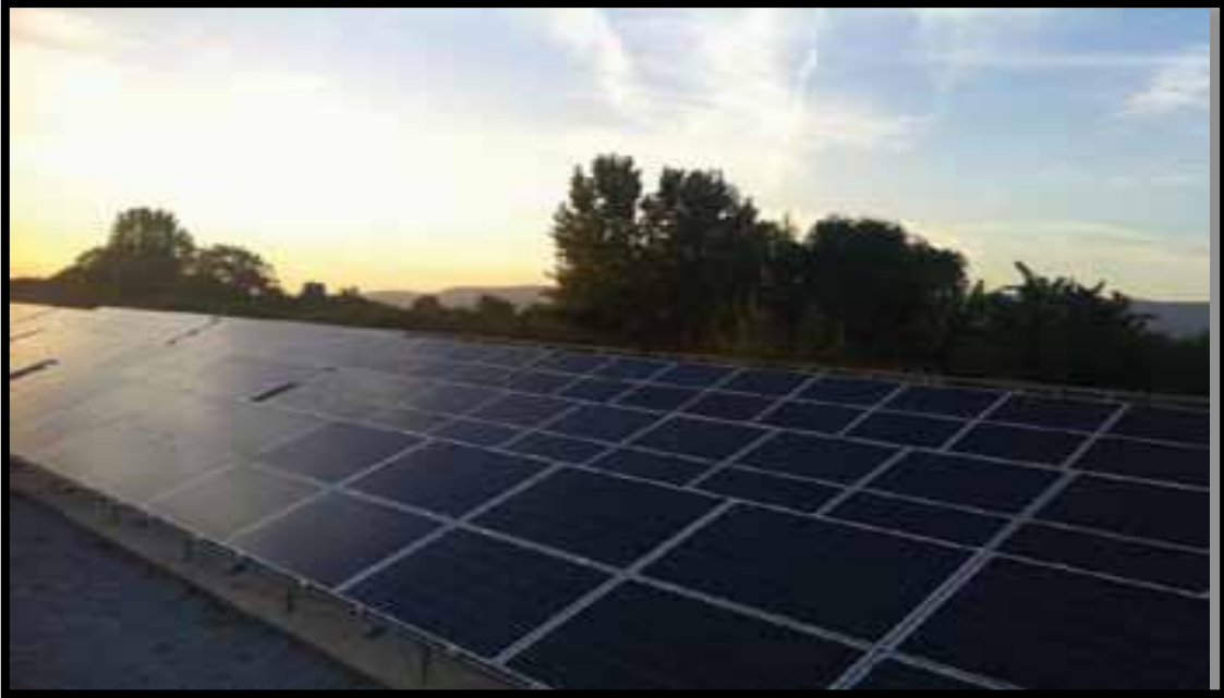
Şekil 12: Bursa'da Gehrlicher Merk Solar Ltd. tarafından kurulan 96 kW'lık grid-connected fotovoltaik sistem.
