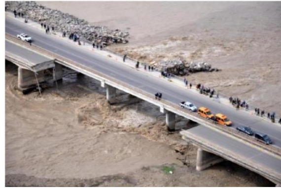
Şekil 1.b İncelenen köprünün kısmi çöken görüntüsü (KGM, 2012)
