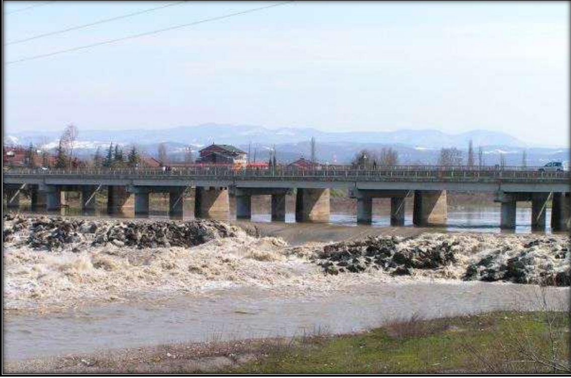
Şekil 6. Köprünün kaya dolgulu bariyerinin yıkılması (KGM, 2012)
