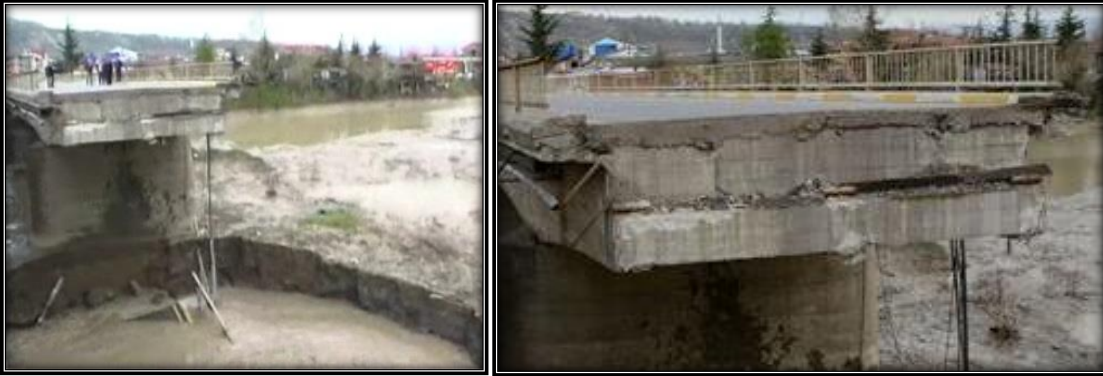
Şekil 7. Köprünün yıkılmasının ardından köprü tabliyesi (KGM, 2012)
