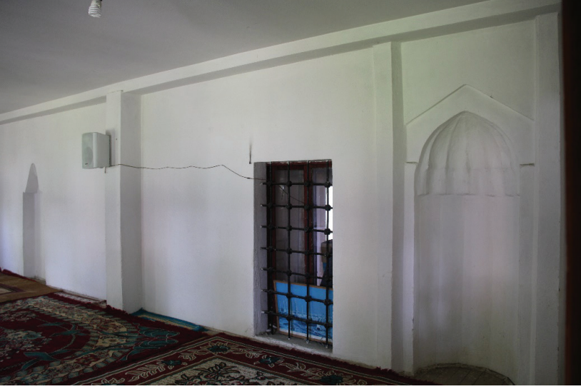
Resim 21. Yakova, Rugova Köyü, Hasan Ağa Camii, kapalı son cemaat yeri, doğu mekân, güney duvardaki dış mihraplar.
