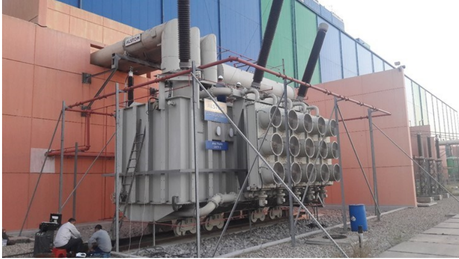
Şekil 1. Trafonun genel görünümü.
