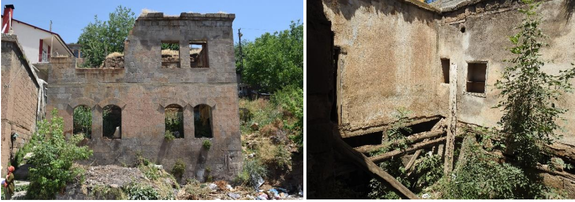
Resim 3. Geleneksel Bitlis evlerinde dam hasar sorunu
