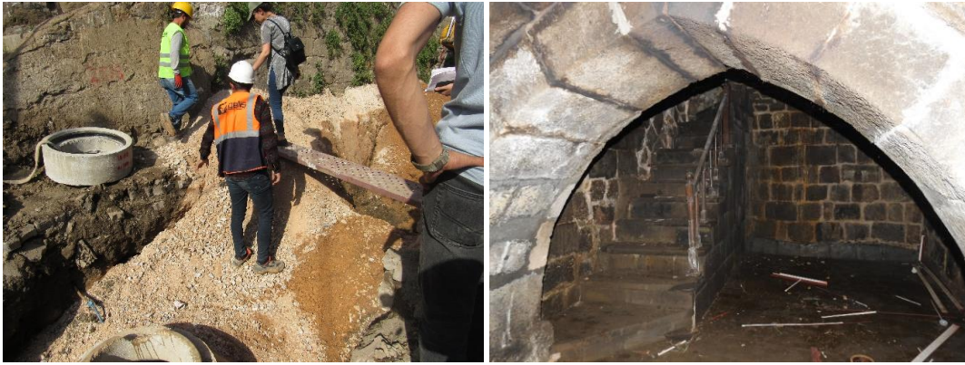
Resim 5. Geleneksel Bitlis evlerinde drenaj sorunu
