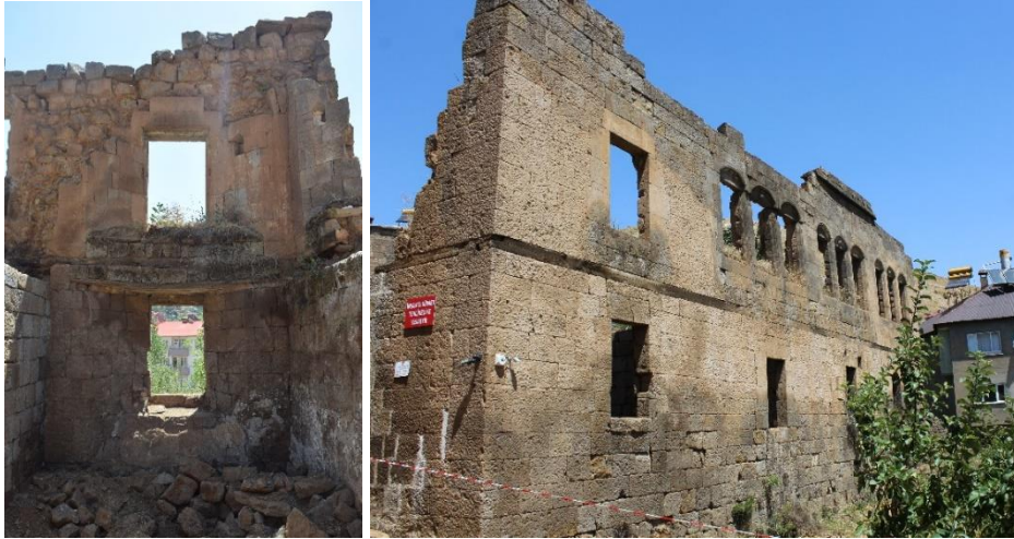
Resim 4. Geleneksel Bitlis evlerinde duvar dağılımları sorunu
