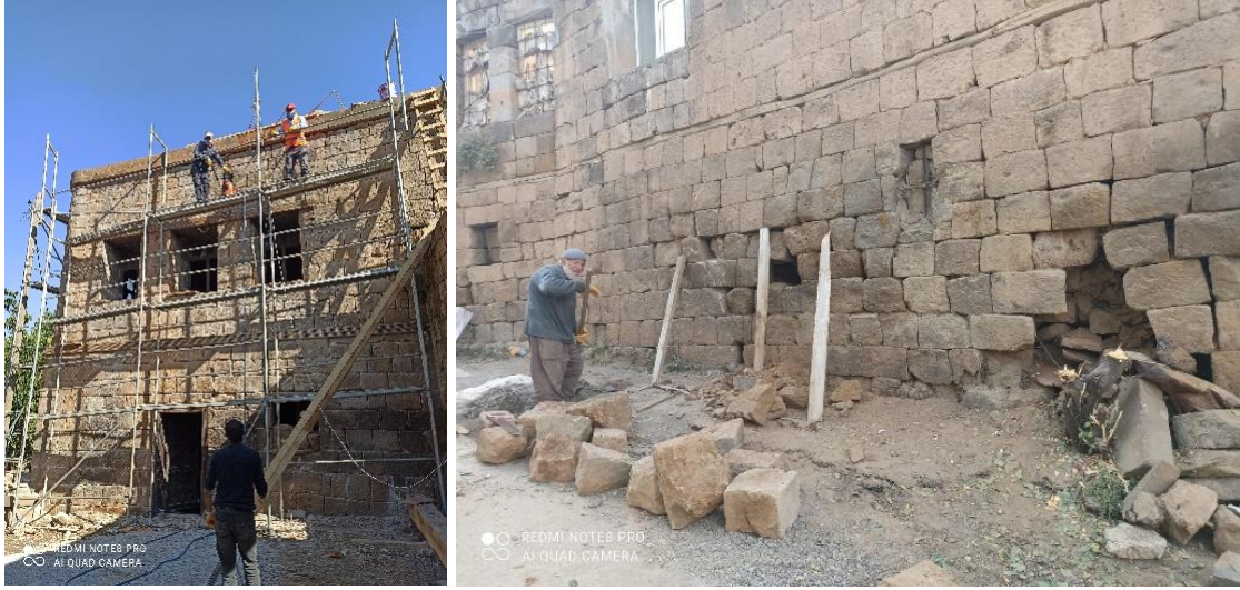
Resim 8. Duvar sorunları çözüm önerileri
