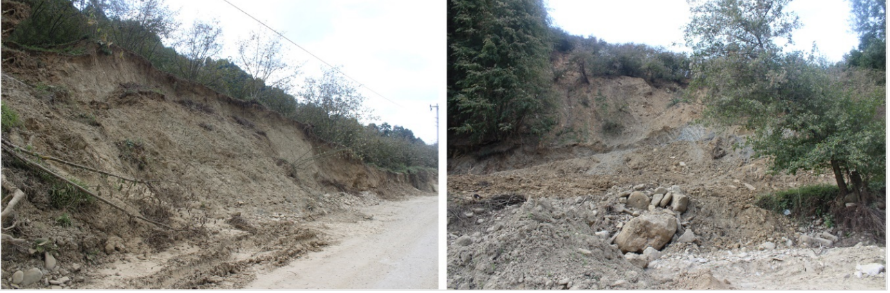
Foto 2. Esmahanım köyünde taşkın olayı ile eş zamanlı meydana gelen heyelanlar
