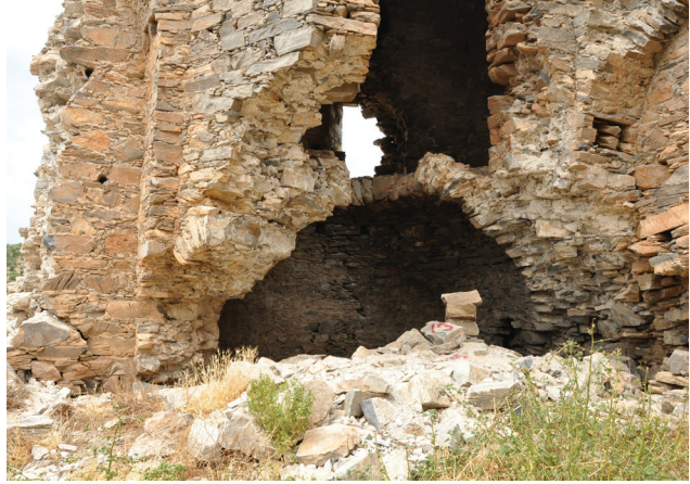
Resim 10 - Dairesel burç, zemin ve birinci katı. Yıkıldıktan soraki durumu.
