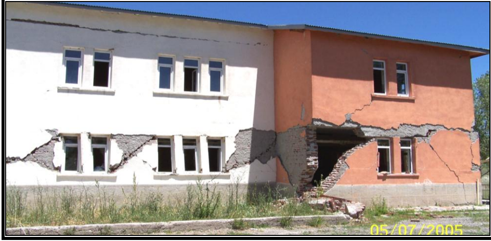
Fotoğraf 7. Depremde ağır hasar gören Kandilli Lisesi.
