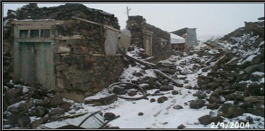
Fotoğraf 5. Atlıkonak köyünde geleneksel yapı malzemesi ile inşa edilmiş konut (Depremde ağır hasar görmüş).
