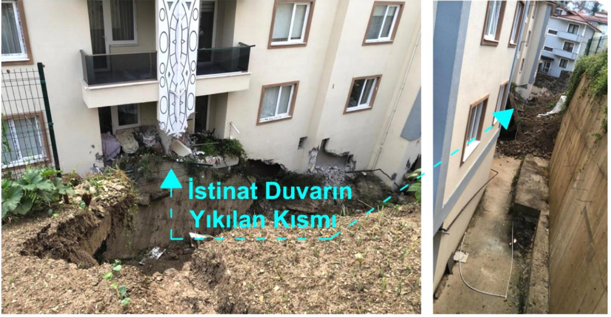
Şekil 7. Haziran 2022 sel baskını sırasında Bartın şehir merkezinde yıkılan istinat duvarı ve binaya verdiği zarar
