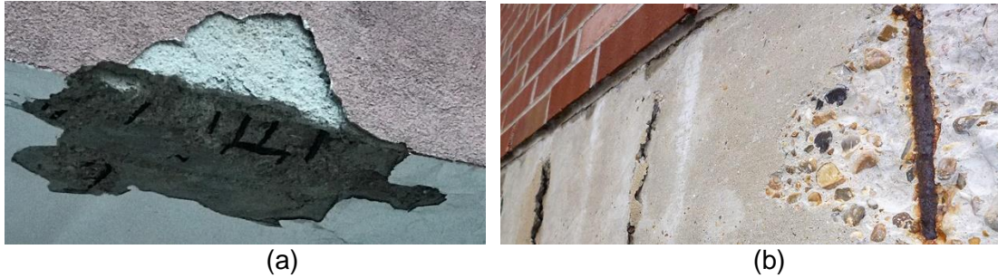
Şekil 5: Demir donatıların korozyonuna bağlı bozulmalar ((a) Fot. Erturan B.; (b) URL-2))
