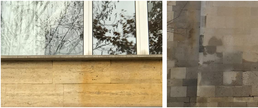
Şekil 15: Taş yüzeyinde görülen renk değişimi (Fot. Erturan B.)
