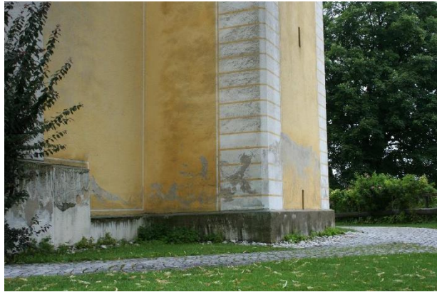
Şekil 8: Su ve ısı etkisi sonucu oluşan yüzey bozulmaları (Freitas, 2013, s.114)
