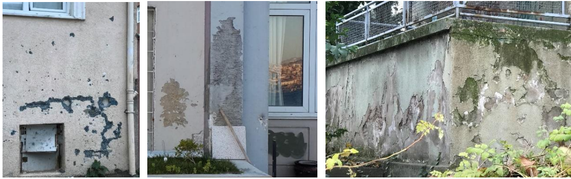
Şekil 20: Cephede oluşan malzeme aşınmaları (Fot. Erturan B.)
