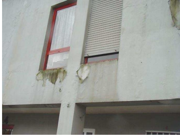
Şekil 12: Denizliği olmayan pencerenin altından akan yağmur sularının neden olduğu kabarma ve dökülmeler (Freitas, 2013, s.126)
