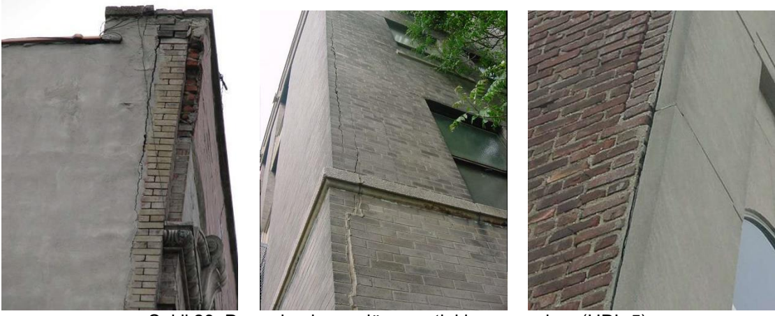
Şekil 23: Duvarda oluşan düşey çatlaklar ve ayrılma (URL-5)
