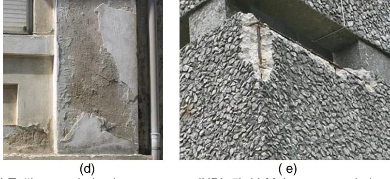
Şekil 19: a) Tuğla yüzeyinde oluşan erozyon (URL-5), b) Malzeme yüzeyinde su nedeniyle oluşan oyuklar (URL-5) c) Yağmur suyu, buzlanma ve eritici kimyasalların etkisiyle ortaya çıkan dökülmeler (URL-5) d) Kohezyon aşınmaları (Freitas, 2013, s.119) e) Beton yüzeyde karbonlaşma ( http://buildingdefectanalysis.co.uk/concrete-defects/concrete-carbonation/ )
