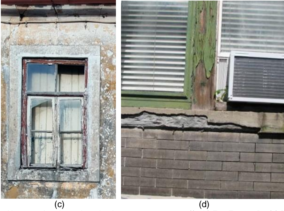
Şekil 7: Ahşap cephe elemanlarında oluşan çürüme sorunu ((a, b) Fot. Erturan B.; (c) Pierra ve diğ., 2020, s.14 ; (d) URL-5, s.105-115)
