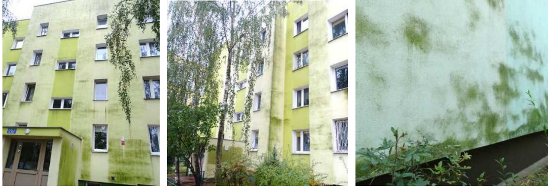
Şekil 26: Cephede bölgesel yosun oluşumları (Knyziak ve Kanoniczak, 2019)
