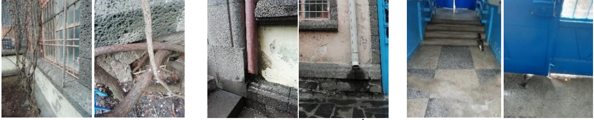
Resim 11. Sarmaşıkların Verdiği Hasarlar; Duvara ve Zemine Zarar Veren Yağmur İniş Boruları; Onarımı Yapılmayan Döşemeler (Yazar Arşivi, 2022)
