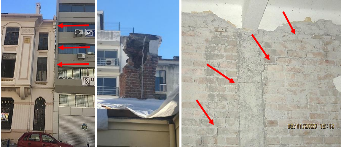
Şekil 5 - 30 Ekim 2020 tarihli deprem sonucunda meydana gelen hasarlar (03.11.2020).
