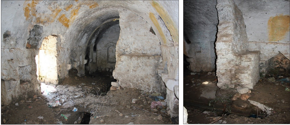
Fotoğraf 7. Aynül Meydan Çamaşırhanesi kısmen yıkılmış ara duvarı / The partially destroyed partition wall of Aynül Meydan Laundry (Doğru, 2019).
