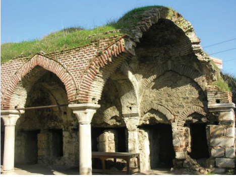
Fot. 8: Uzun kanadın doğu ucunda kısmen yıkılmış kubbe.
