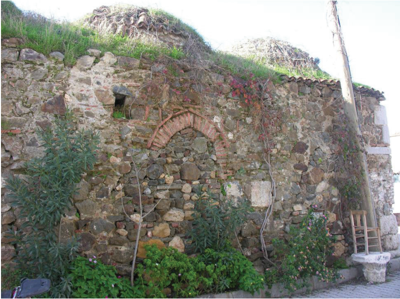
Fot. 14: Doğu duvarı üzerindeki pencere izleri.
