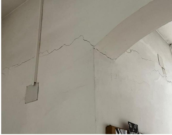
Şekil 9. Duvar-kiriş birleşim bölgesinde çatlak
