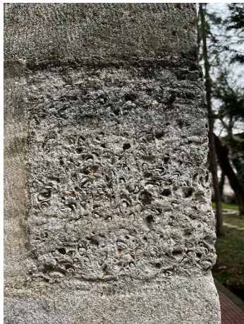
Şekil 13. Köşe kesme taşa görülen bozulma
