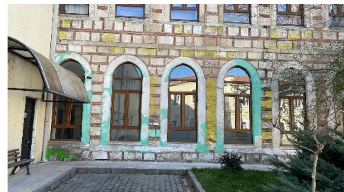
Şekil 20-21-22. Kuzeybatı kanadı avlu cephesi bozulma haritaları
