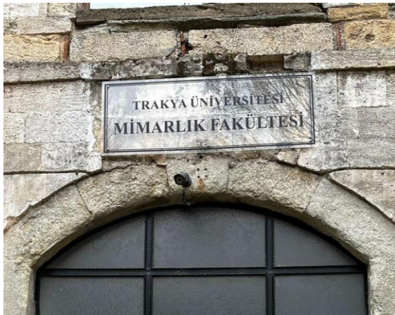
Şekil 11. Giriş cephesi üzerinde parça kayıpları
