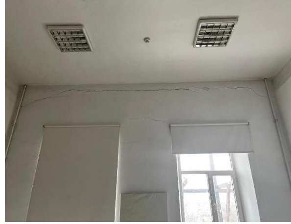
Şekil 10. Duvarın kirişten ayrılması
