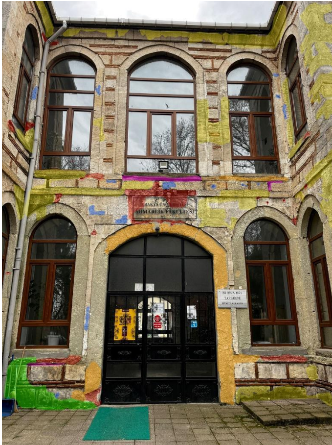
Şekil 19. Kuzeybatı kanadı giriş cephesi bozulma haritası
