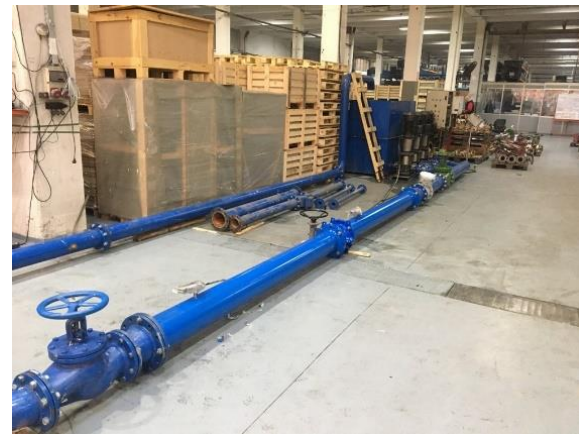
Şekil 17. Kv test düzeneği
