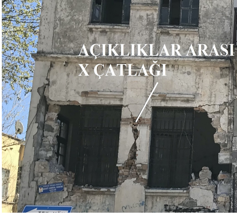
Şekil 10. Açıklıklar arası X çatlağı oluşumu (Kayabaşı mahallesinde bir konak) (X crack formation between openings (a mansion in Kayabaşı neighborhood))
