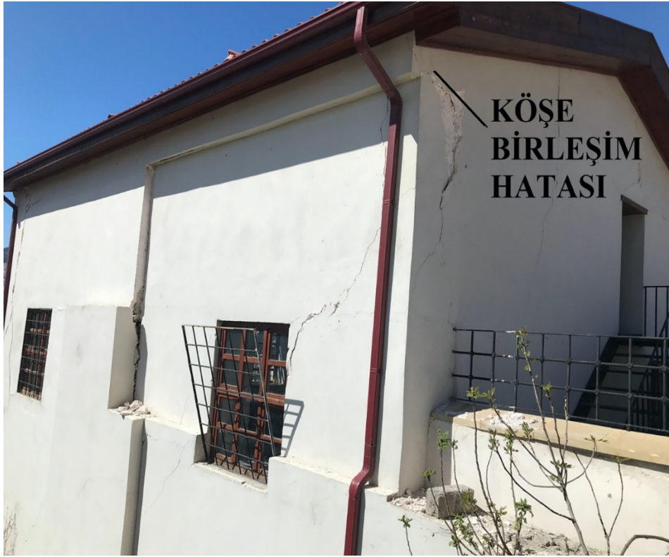
Şekil 16. Rijit Köşe bağlantısı olmayan duvarda çatlak (Şih Müslüm Camii) (Crack in wall without rigid corner connection (Şih Müslüm Mosque))
