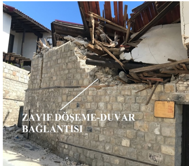
Şekil 8. Zayıf döşeme-duvar bağlantısı (Turan mahallesindeki bir konak) (Weak floor-wall connection (a mansion in Turan neighborhood))
