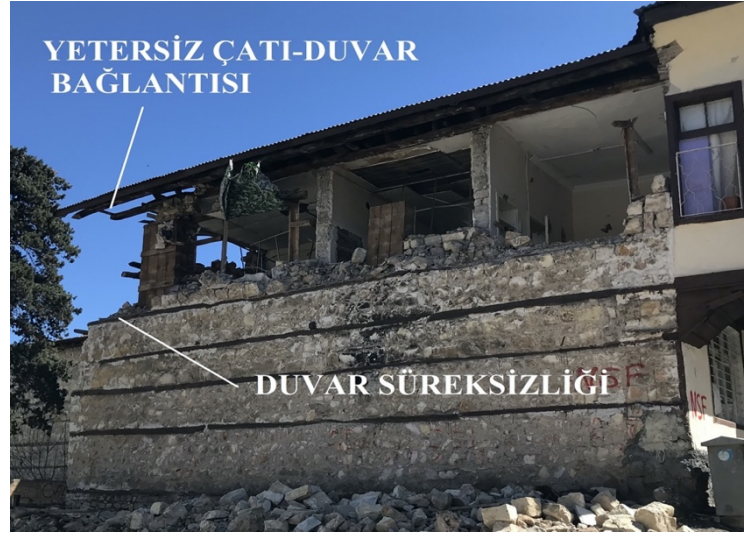
Şekil 6. Duvar süreksizliği (Kayabaşı mahallesinde bir konak) (Wall discontinuity (a mansion in Kayabaşı neighborhood))
