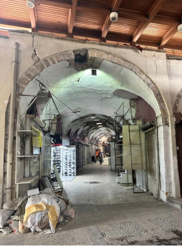
Fot.31: Maraş Kapalı Çarşısı, 6 Şubat 2023 depremi sonrası güney (Bakırcılar Çarşısı) kapısı (İ. Demirkol Bayrak)
