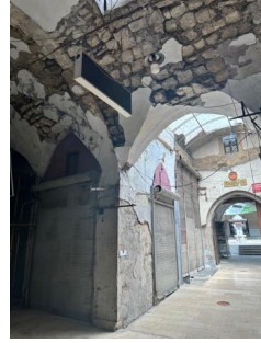
Fot.34: Maraş Kapalı Çarşısı, 6 Şubat 2023 depremi sonrası, Taş Han giriş holü (İ. Demirkol Bayrak)
