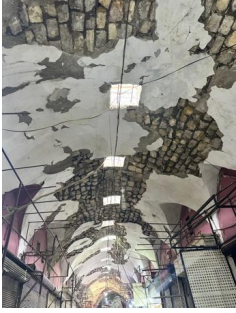
Fot.33: Maraş Kapalı Çarşısı, 6 Şubat 2023 depremi sonrası Bezirgânlar Arastası hasar durumu (İ. Demirkol Bayrak)
