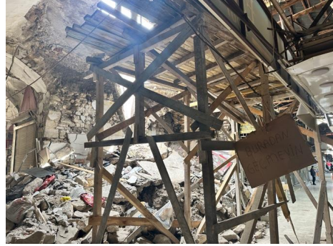
Fot.36: Maraş Kapalı Çarşısı, 6 Şubat 2023 depremi sonrası, Kavaflar Arastası 1773 ada 21-22 ve 23 parsellerde çöken dükkânlar (İ. Demirkol Bayrak)
