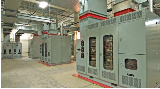
Şekil 10. Trafo Odası, Washington DC/ABD (c3mpowersystems.com, 2019)
