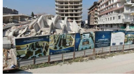
Şekil 19. Depremden sonra Altınpark 2 Sitesi (Sosyal TV, 2023)
