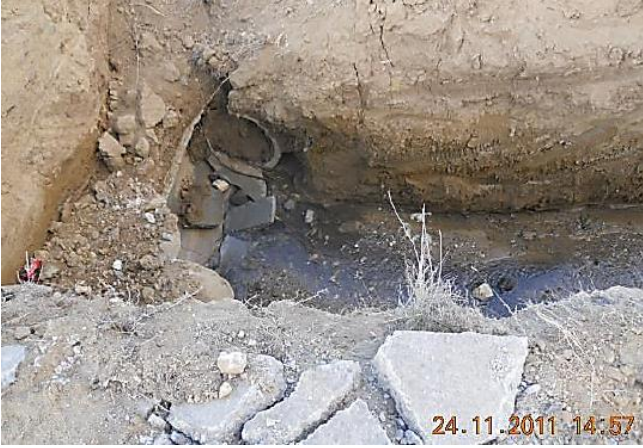
Şekil 3. OSB alanında görülen su kaçağı
