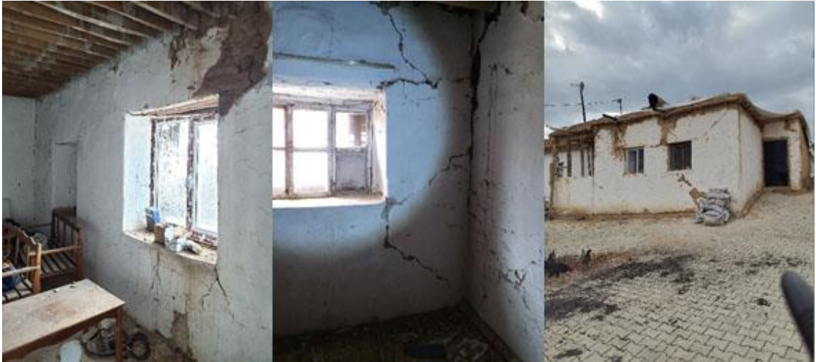
Şekil 13. Yığma yapılarda B tipi orta hasar örneği, Çayırköy Mahallesi (İnş. Müh. Kadir Bostancı Arşivi)
