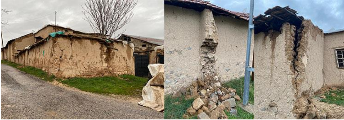
Şekil 15. Yığma yapılarda C tipi ağır hasar örneği, Çayırköy Mahallesi (İnş. Müh. Kadir Bostancı Arşivi)
